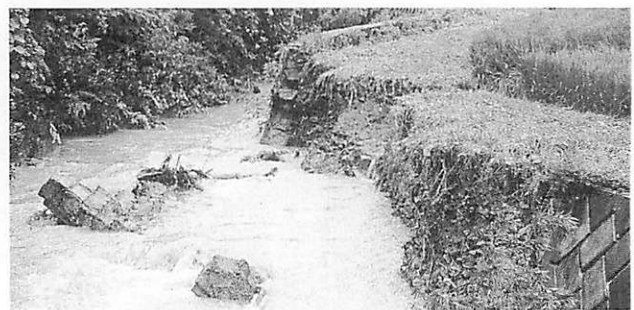
▲護岸のブロックが崩れ落ちる(太田地区)
