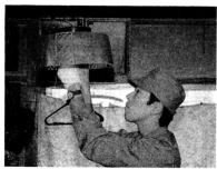
▲蛍光灯の点検をする職員
