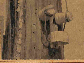
街灯の電柱の下の方に、こんなスイッチがある。不用の時はずめて下さい。
