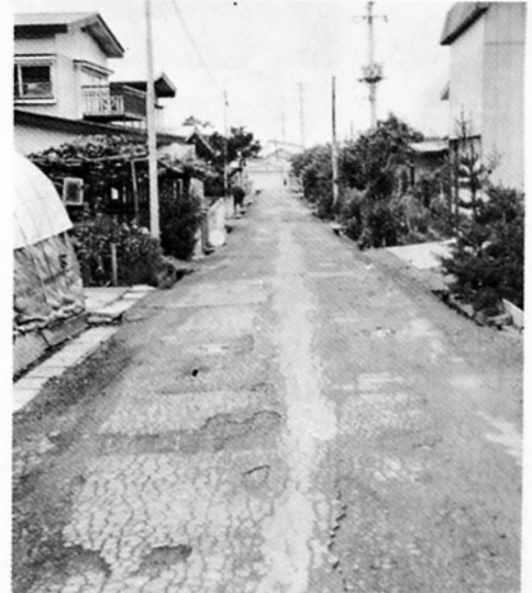
凍上災害にあったアスファルト道路
