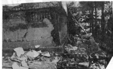
崩れた土蔵のレンガ — 沢部 —
