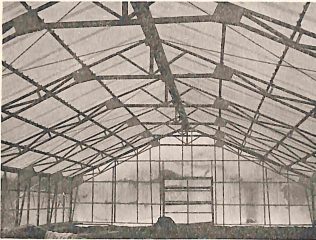
〔営農パイロット育苗施設〕
