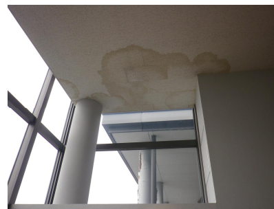
天井からの雨漏り
