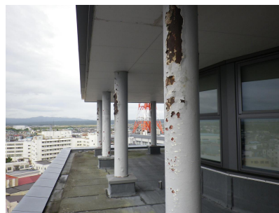
屋上設備の腐食
