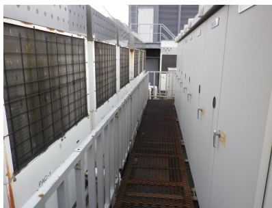
空調設備の劣化
