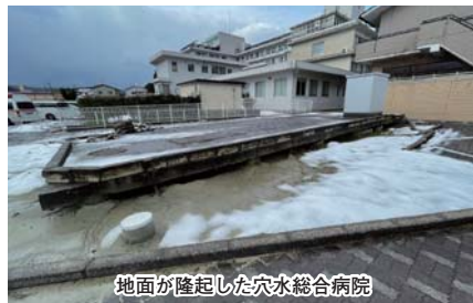
地面が隆起した穴水総合病院
