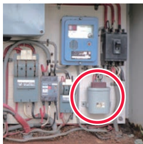
分電盤内の低圧コンデンサー
