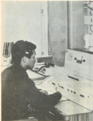
火災情報装置が設置された通信司令室
