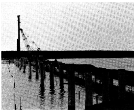
十三湖中島遊歩道橋は9月完成をめざして、急ピッチで進められている。
